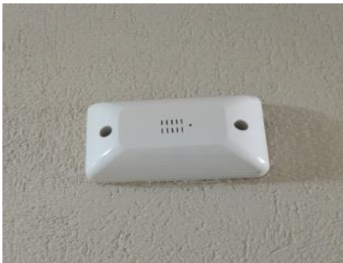
Alarma de Incendio
