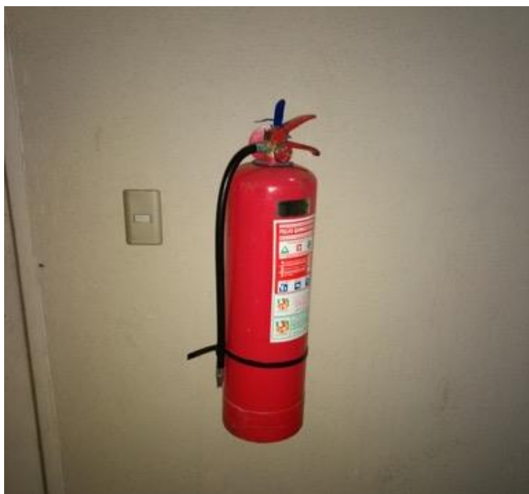
Extintores del Edificio
